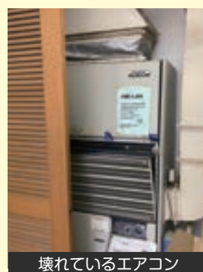
壊れているエアコン
